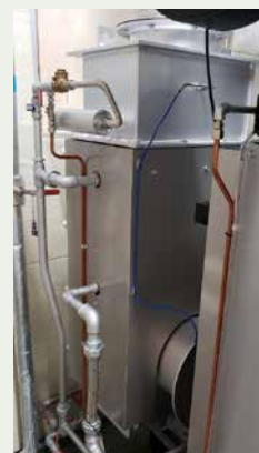
新たに導入した熱交換装置
