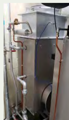
新たに導入した熱交換装置
