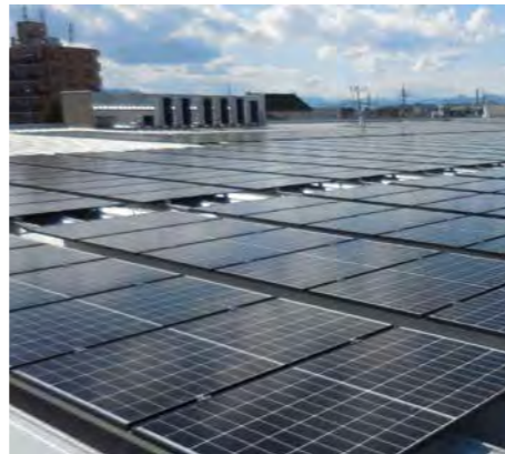
店舗の屋根に設置した太陽光パネル
